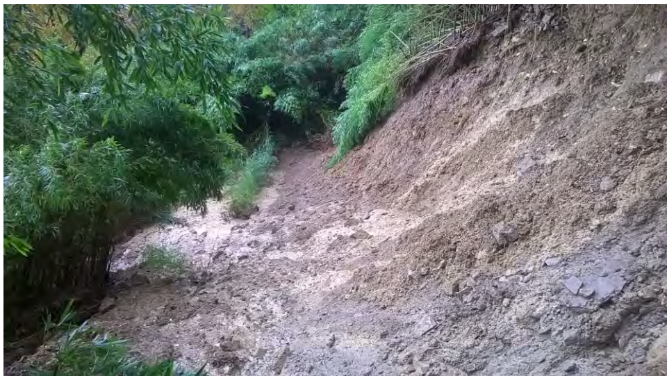
Figura 37 – Alluvione 2014 – Dissesto Strada Vedronza-Lusevera
